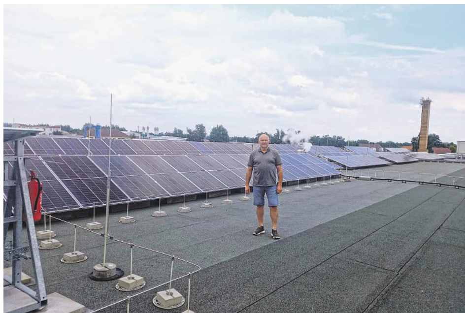
Nový zdroj páry Díky programu Úspory energie navýšila firma RETRE – prádelna a čistírna výkon své fotovoltaické elektrárny. Dnes má nejmodernější strojní zařízení v oboru. Foto: archiv RETRE
