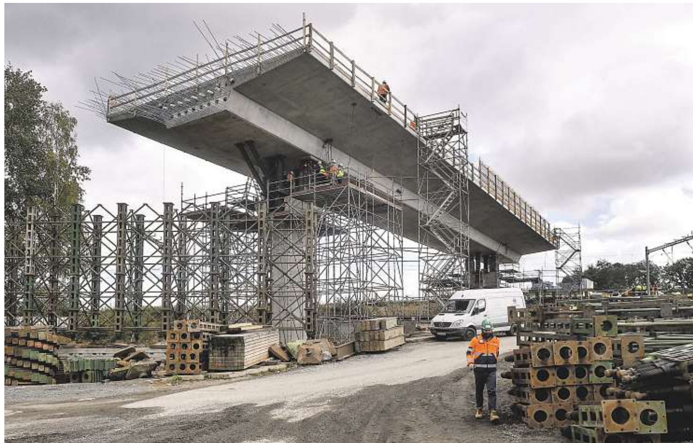
Skokový růst cen materiálů podražuje stavby. Například betonářská ocelová výztuž podražila a od loňského léta stagnuje na cenách vyšších o téměř 80 procent. (Na snímku z loňského listopadu je most nad železniční tratí u Havlíčkova Brodu.)
