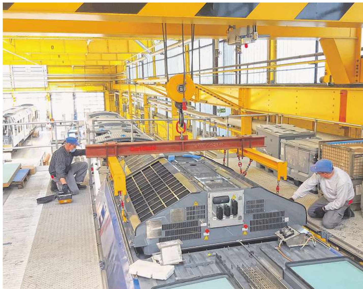
Palivový článek vodíkového vlaku je připevněn na střeše.
