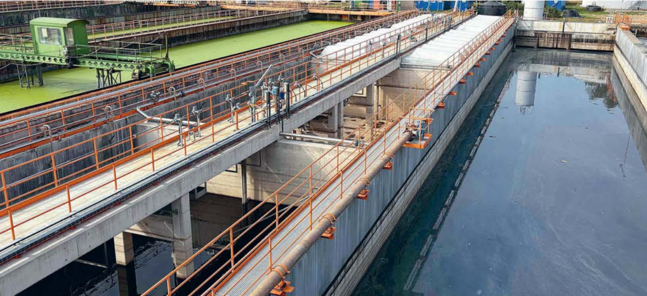
Odstraňování dusíku Pohled na nádrže anammox na pardubické čistírně odpadních vod. Zdroj: Archiv VaK Pardubice
