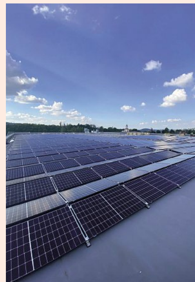
Pohled na fotovoltaické panely na střeše společnosti TOS Varnsdorf.
