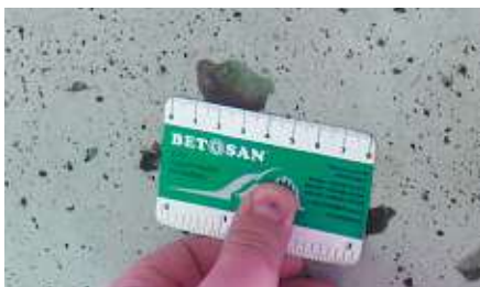
Velké póry v povrchu betonu.
