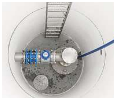
Průtokoměr umístěný v šachtici
