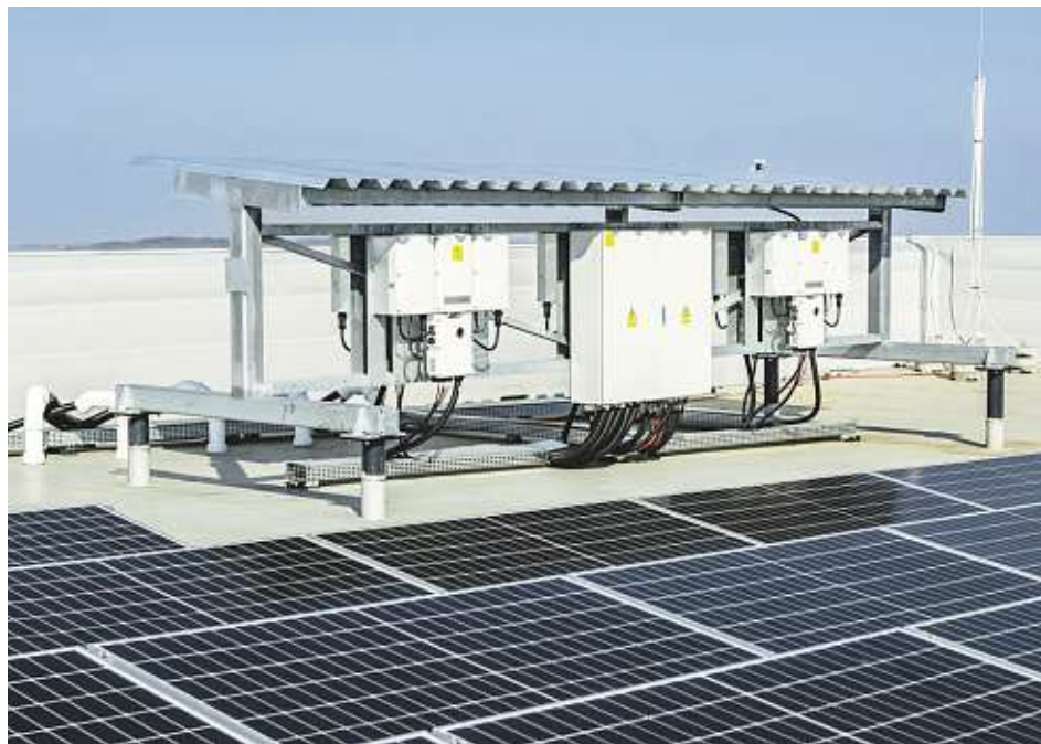
Instalace fotovoltaiky na Majalandu. Nákupní a obchodní centrum si s pomocí dotací nechalo rozšířit původní. Opět u společnosti Atlantis Management. Foto: Atlantis Management
