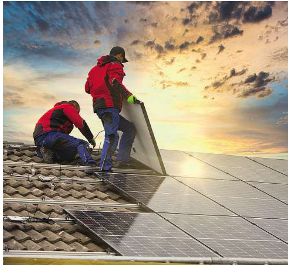
Soláry na domech Poptávka po domácí fotovoltaiické elektrárně v Česku roste. Při výkonu elektrárny do 10 kilowattů není zapotřebí licence. Foto: Shutterstock
