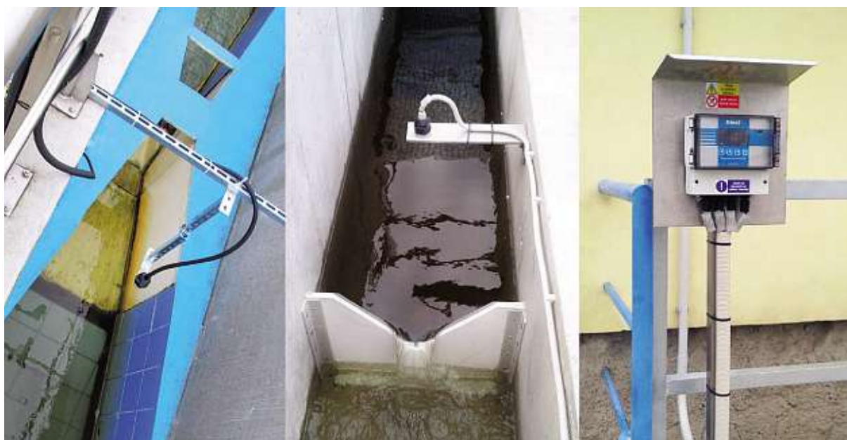
Měření průtoku v Parsallově žlabu a v měrném přelivu na odtoku v ČOV, sestava hladinoměru ULM-53 a vyhodnocovací jednotka FCU-400.
