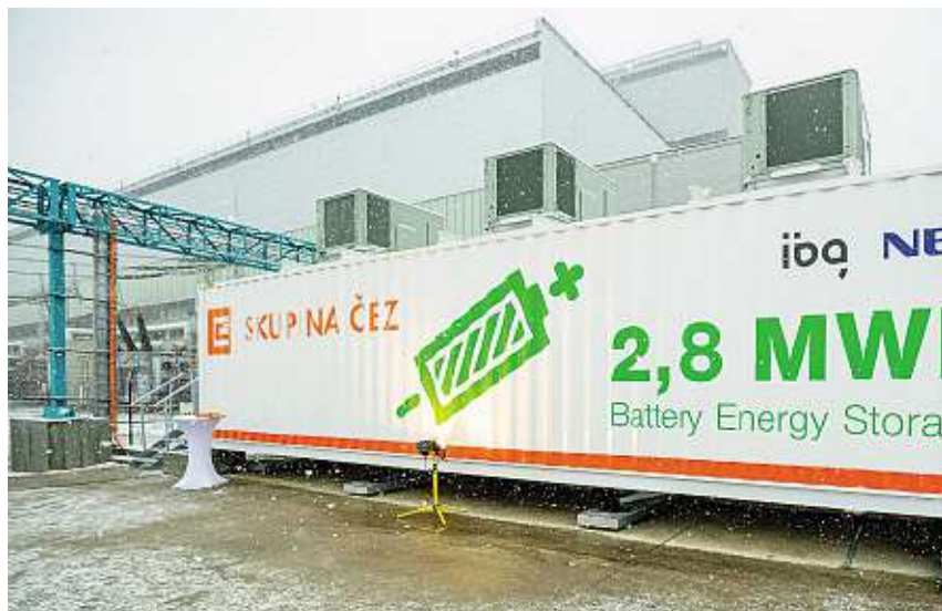
Bateriové úložiště vybudované společností ČEZ a ČEPS v areálu Elektráren Tušimice.
