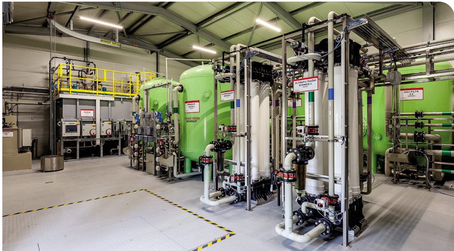
Úprava pitné vody Arxada Biotec s finálním stupněm sorpcí na aktivním uhlí
