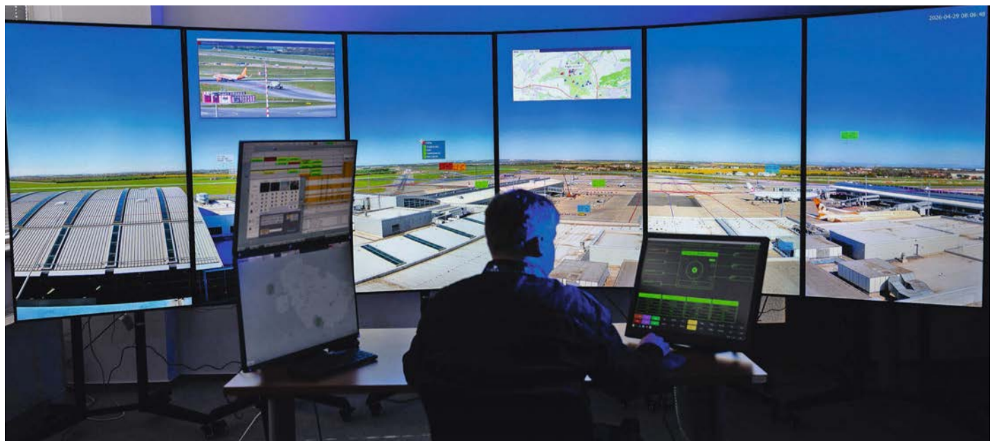
Digitální platforma poskytuje řídicím letového provozu stejnou, a v řadě situací i vyšší úroveň situačního přehledu než klasické stanoviště letištní řídicí věže. Umožňuje řídit provoz z jednoho vzdáleného pracoviště i pro více letišť současně.
