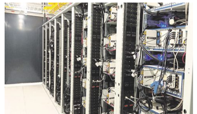
Instalace Hardware-in-the-Loop, na které detekční kamery virtuálně „projedou“ dopravní scénáře.
