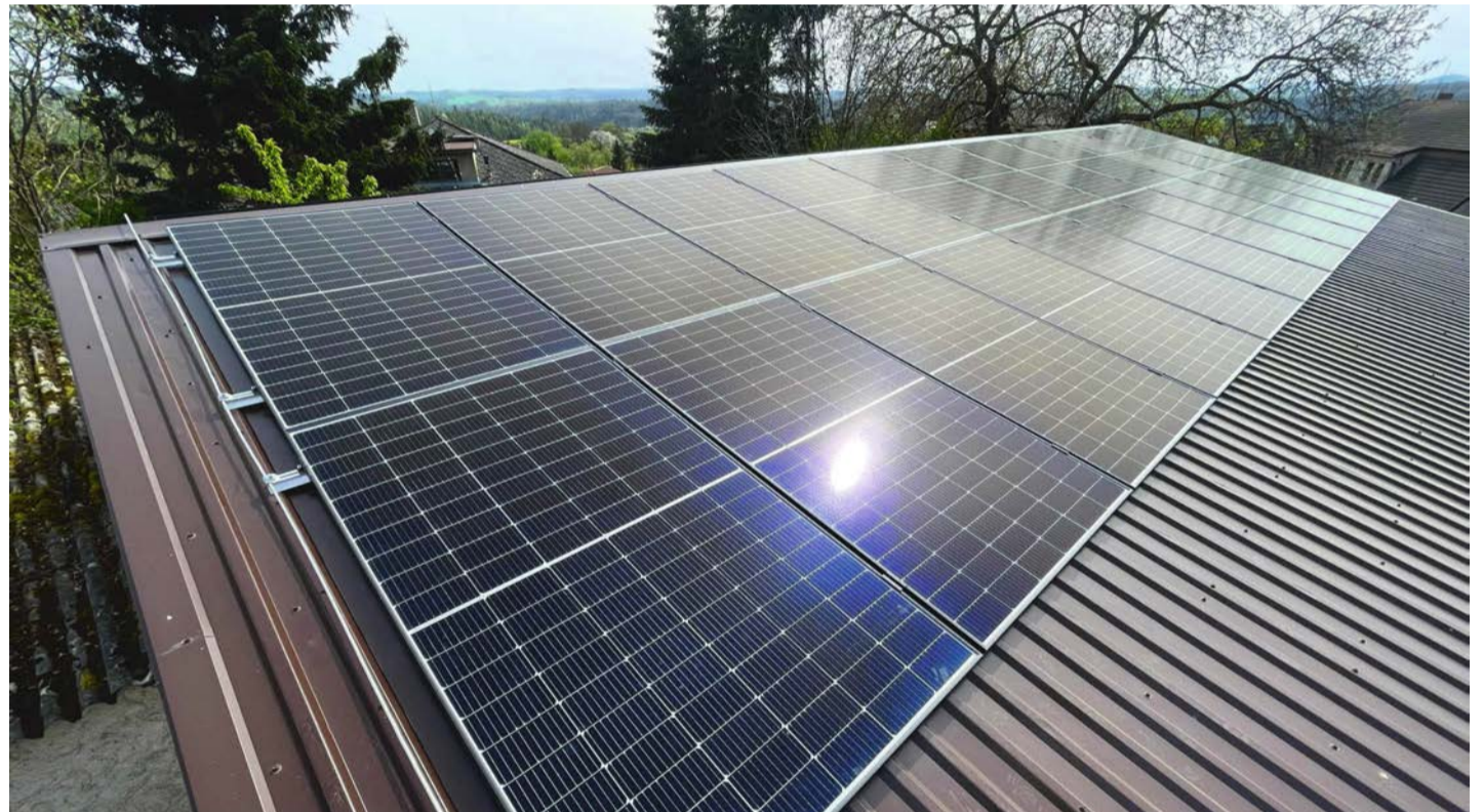
Obecní zelená energie Firma Sefy realizovala pro středočeskou obec Soběhrdy fotovoltaiku na několika budovách – kabině fotbalového hřiště, místním obchodě a hasičské klubovně. Energií sdílejí i další obecní budovy. Foto: Sefy
