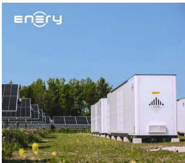
Eney Portfolio Optimization pomáhá provozovatelům bateriových úložišť lépe řídit jejich provoz. Zdroj: Eney
